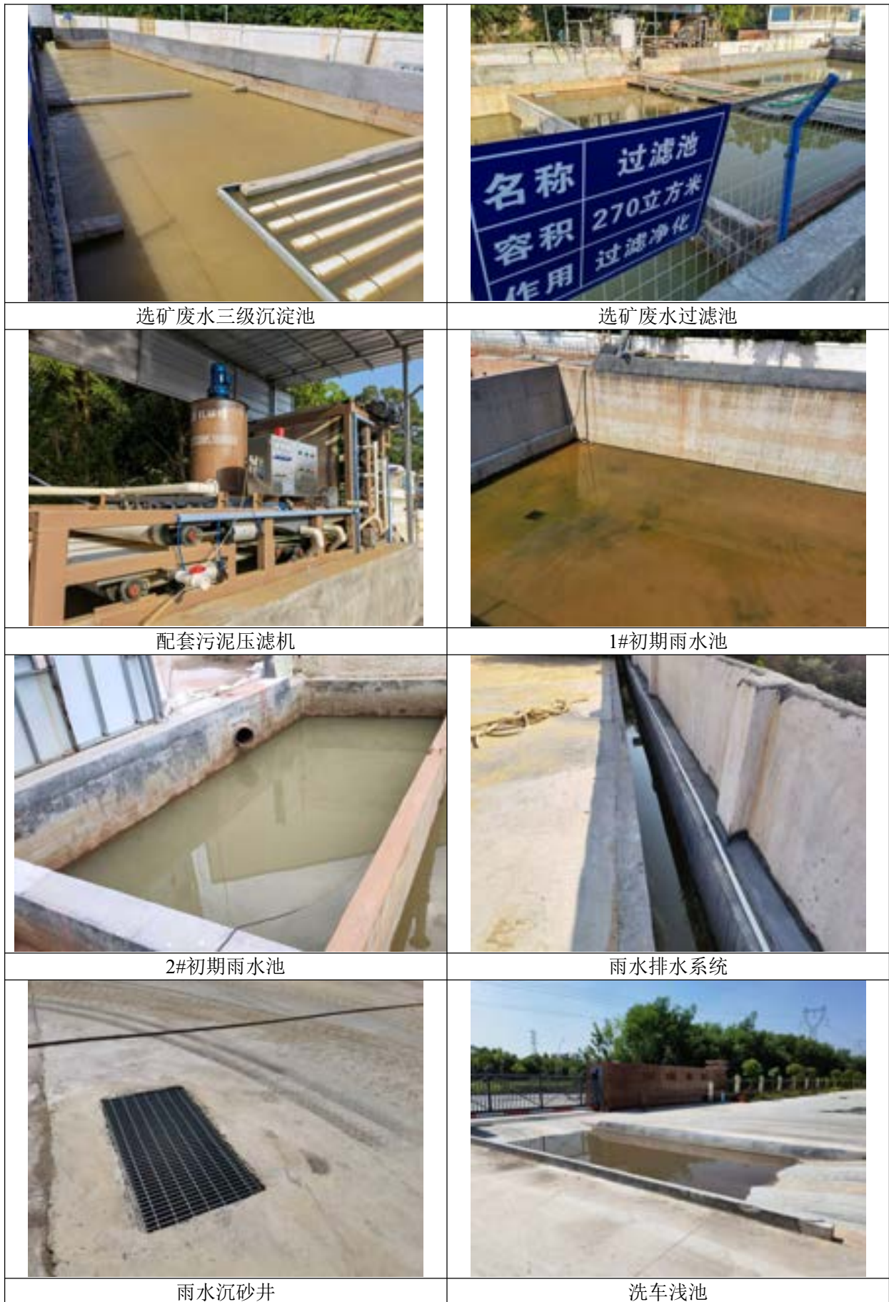
图 4.2-1 废水治理设施照片
