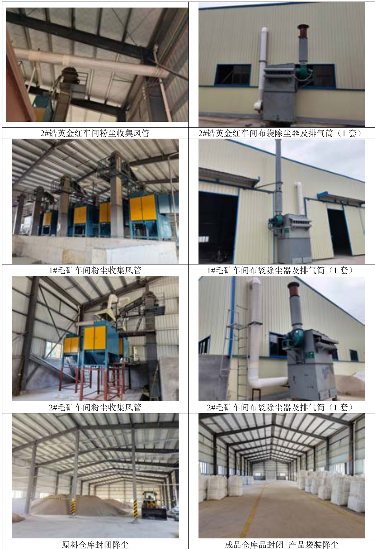
图 4.2-2 废气治理设施实景图
