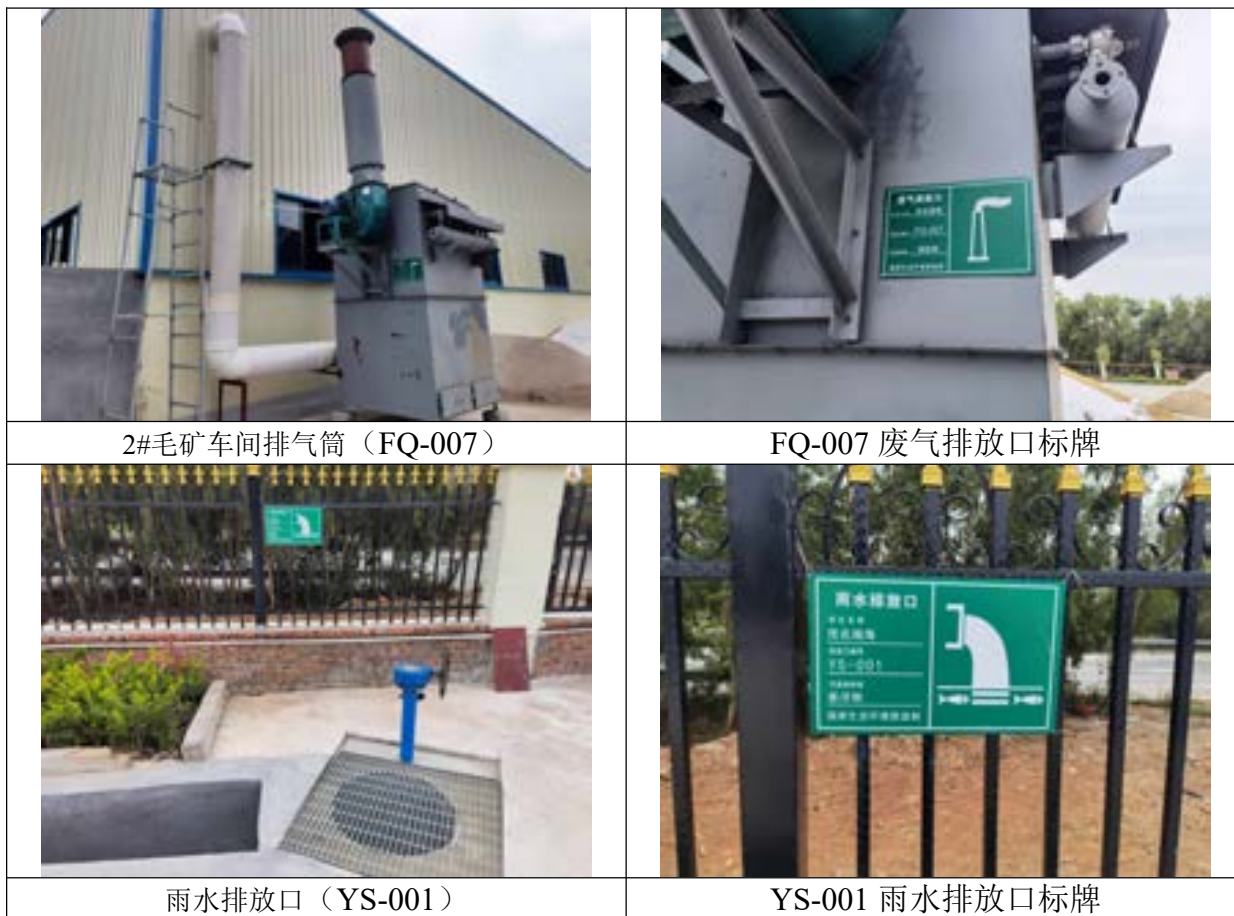
图 4.3-2 本项目规范化废气排放口、雨水排放口实景图
