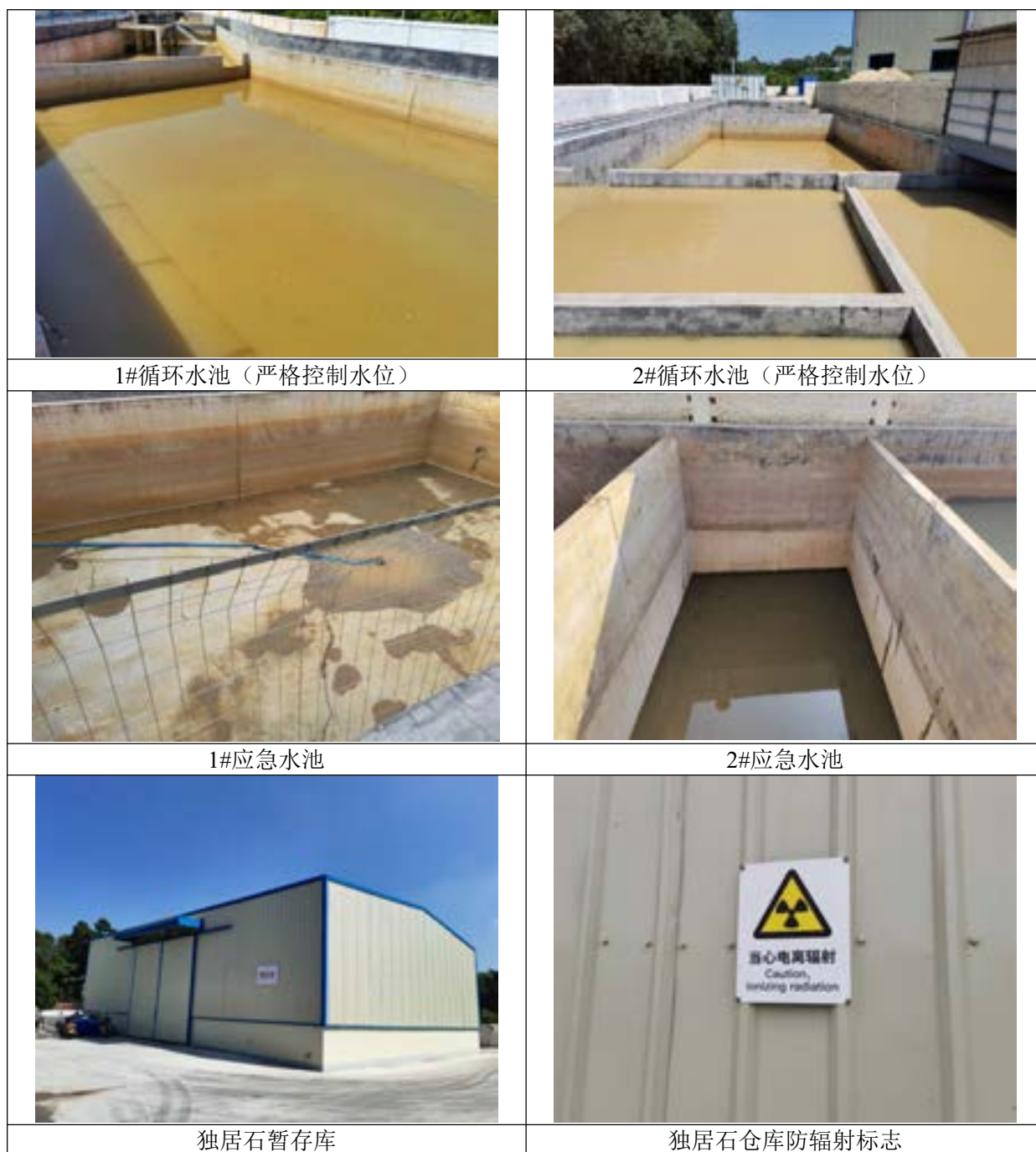
图 4.2-1 本项目风险防范设施实景图
