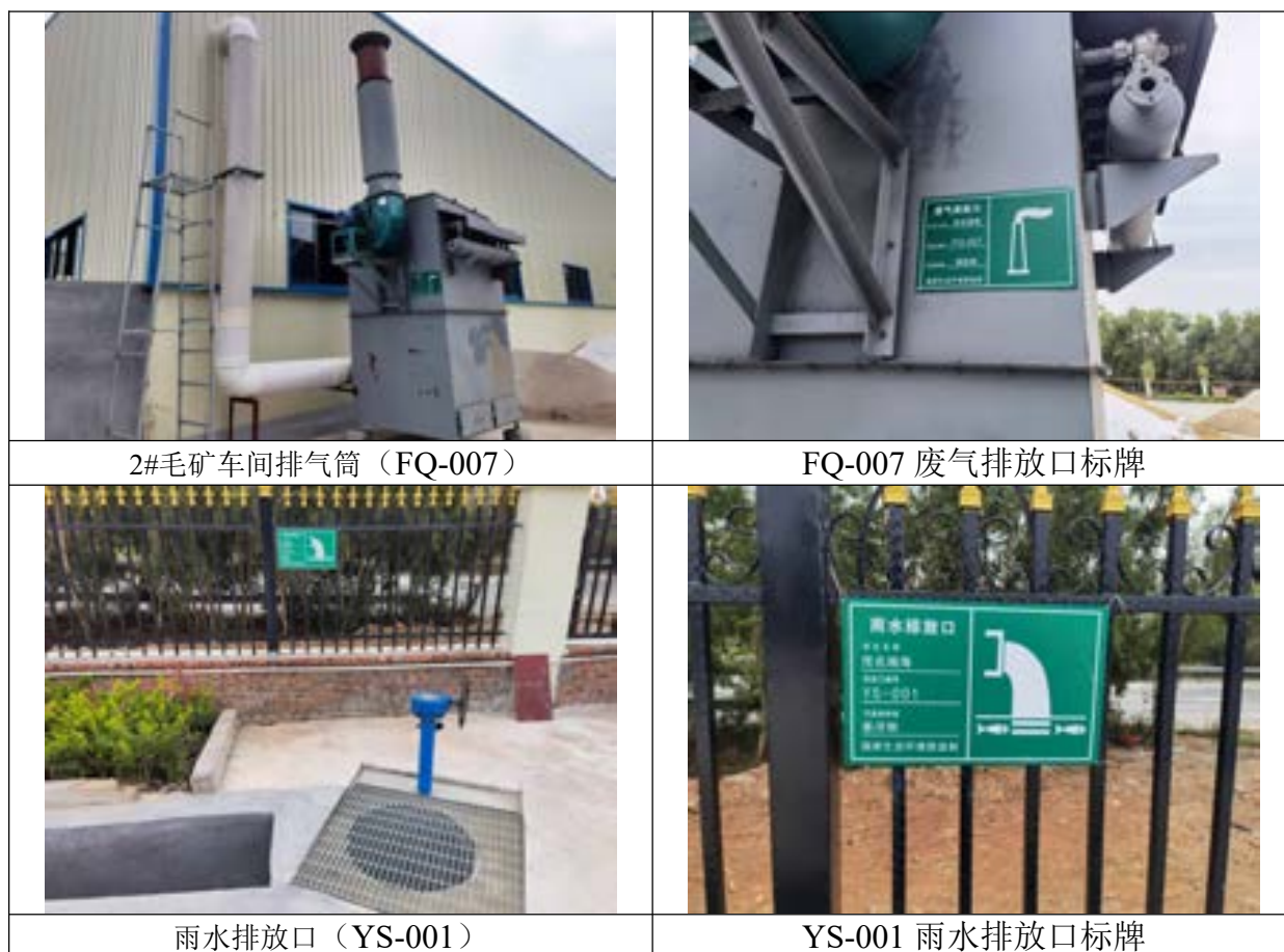
图 4.2-2 本项目规范化废气排放口、雨水排放口实景图
